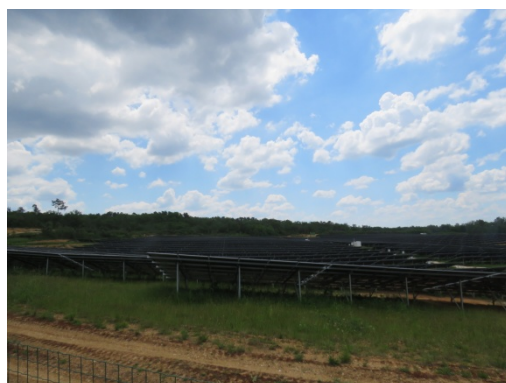
Parc photovoltaïque au sud de la ZIP
